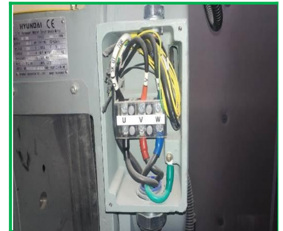
전동기 단자대의 보호덮개 설치 안됨
