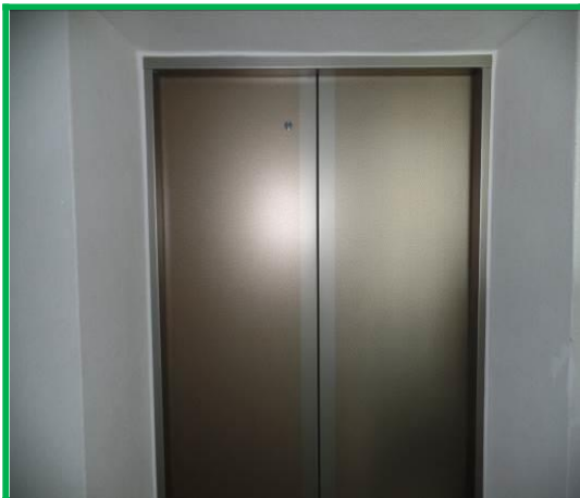
승강장문 안전스티커 및 비상용표지 미부착
