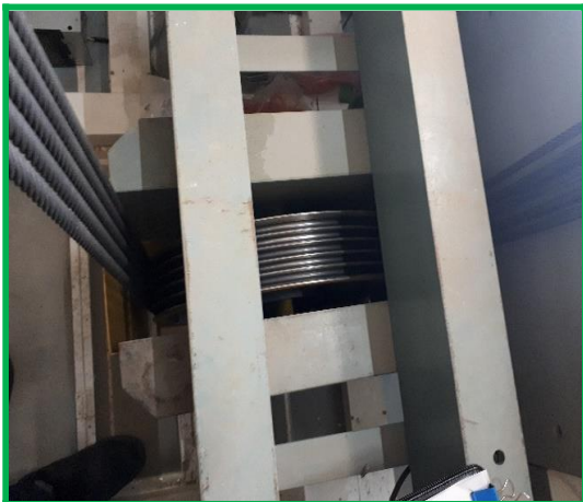
카 상부 도르래 보호커버 없음
