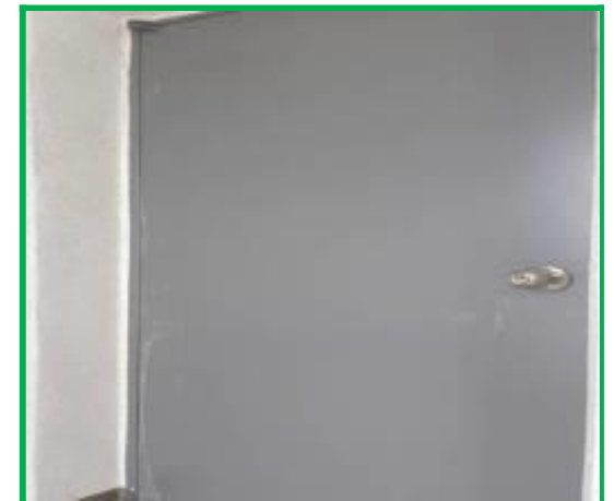
기계실 출입문 주의표지 없음
