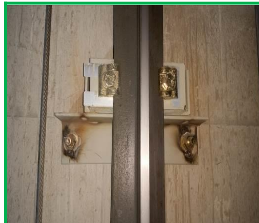
레일브라켓 앵커볼트 도장처리 안됨
