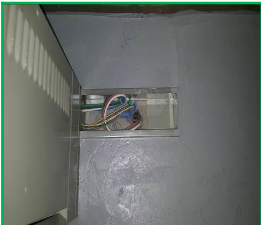
제어반 전선 배관덕트 보호커버 없음
