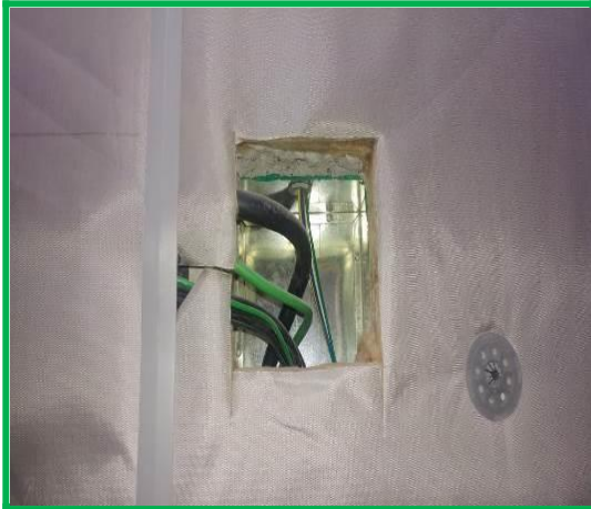
기계실벽면에 케이블 점검구 마감조치 안됨
