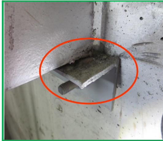
카축 가이드레일 브라켓 용접부 깨짐
