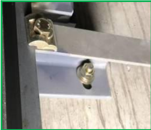
레일 브라켓 앵커볼트 2개소 점용접 안됨
