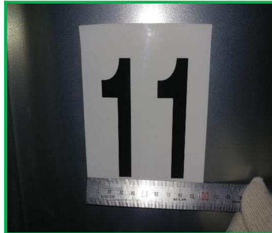
승강로 층 표지판의 재질 및 규격미달
