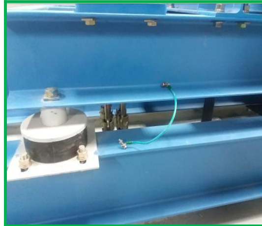
권상기 빔 접지선 시공 안됨
