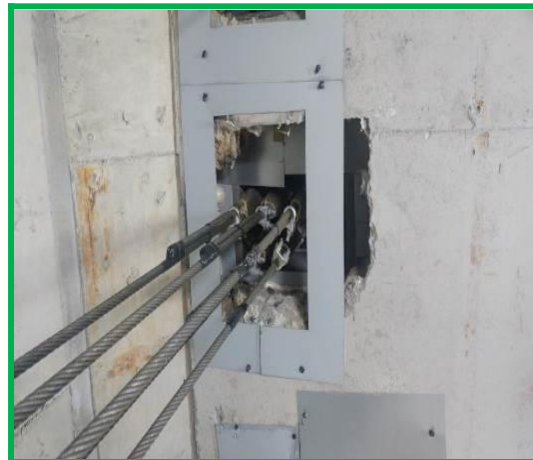
승강로 천정 로프구멍 마가 미흡
