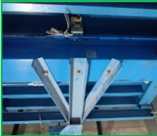
카 하부 완충기 충돌판 설치 안됨
