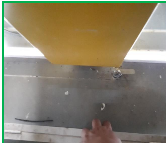
카 상부 비상구출구 개방불가
