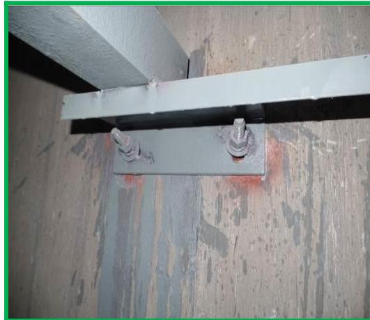
레일브라켓 앵커볼트 설치상태 불량
