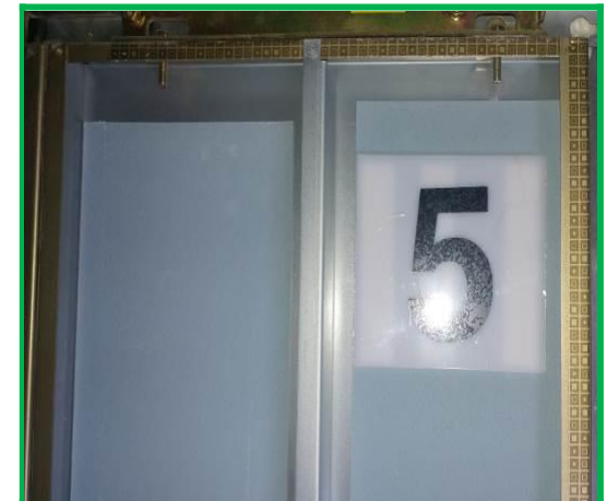
승강로 층 표시 부착 안됨
