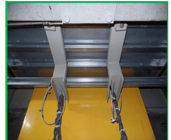
고정브라켓에 설치된 균형체인
