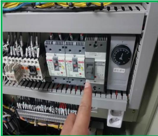
제어반 배선차단기 누전 발생
