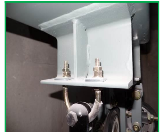
균형체인 고정볼트 분할핀 설치 안됨
