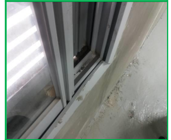
기계실 창문틀 파손
