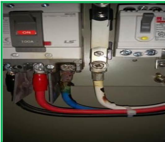
주 전원 배선차단기 단자 손상
