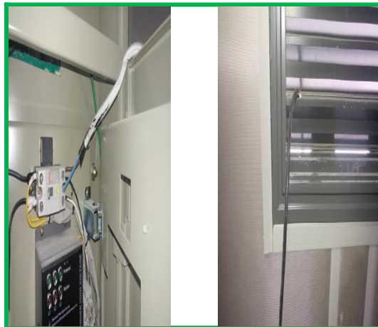
기계실분전반의 조명용 차단기 타용도로 분기되어 사용됨.
