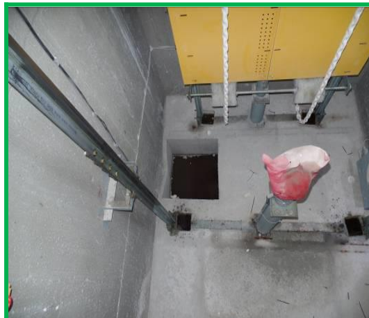
피트내 배수펌프 및 배관 설치 안됨
