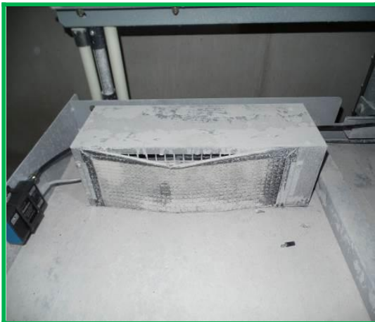
카 상부 청결상태 불량 및 송풍기 커버 파손
