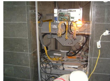
[카 상부 배선 및 결선]
