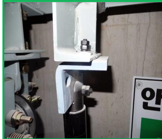
균형체인 고정볼트 분할핀 설치 안됨
