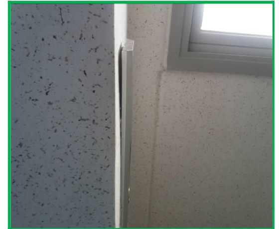
승강장 호출장치 설치불량
