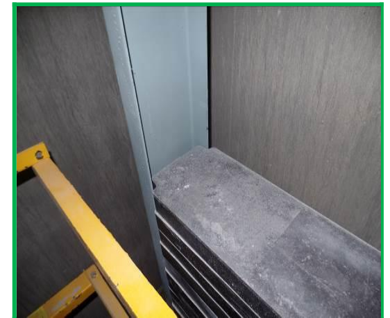
균형추 고정브라켓 설치 안됨
